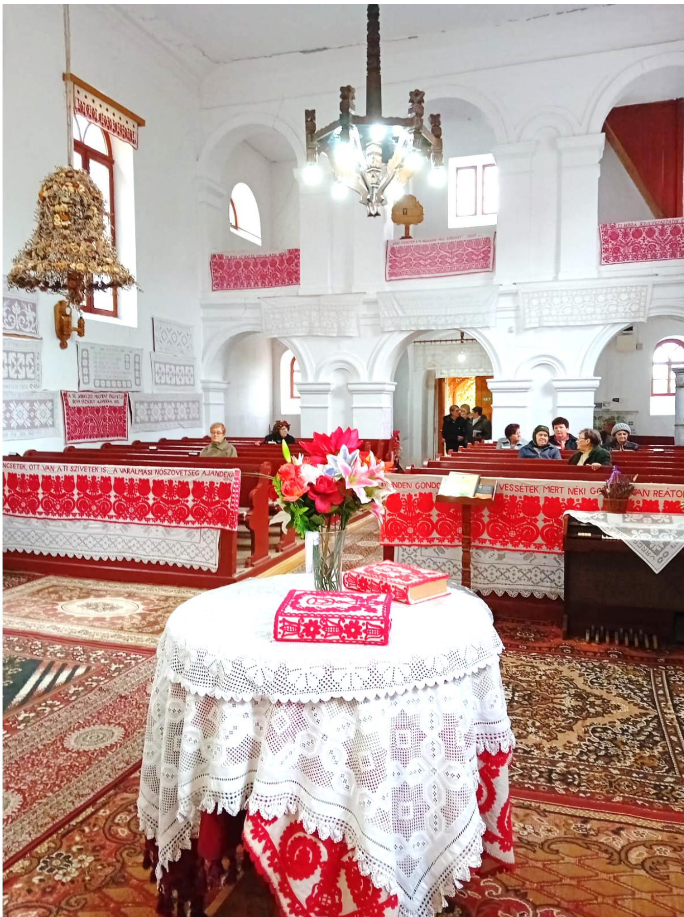
Auch im Innenraum der Kirche sind turmseitig Risse an der Decke sichtbar.
